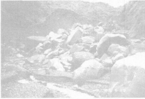
图 6 采莫洛沟沟道堵塞严重
